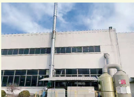
废气处理装置(喷淋+光氧+活性炭)
